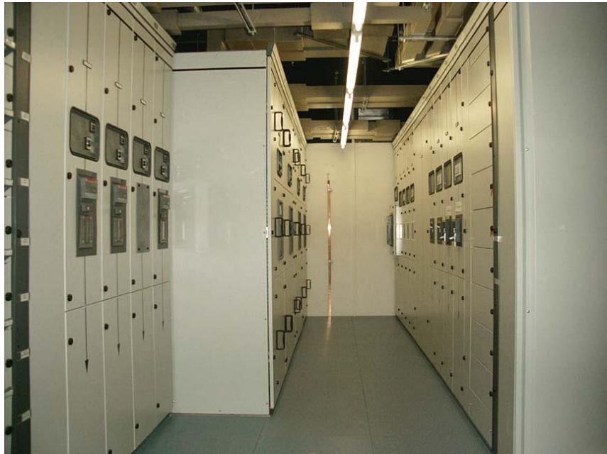
Abbildung 2: Starkstrom-Schaltanlage für ein Data Center.
