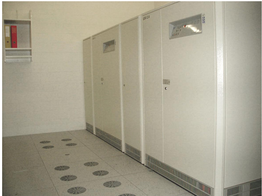
Abbildung 2: USV-Anlagen mit je 120 kVA
