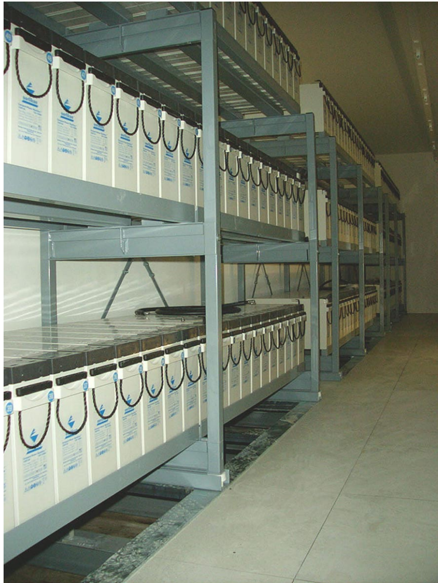
Abbildung 3: Batterieanlage zu USV
